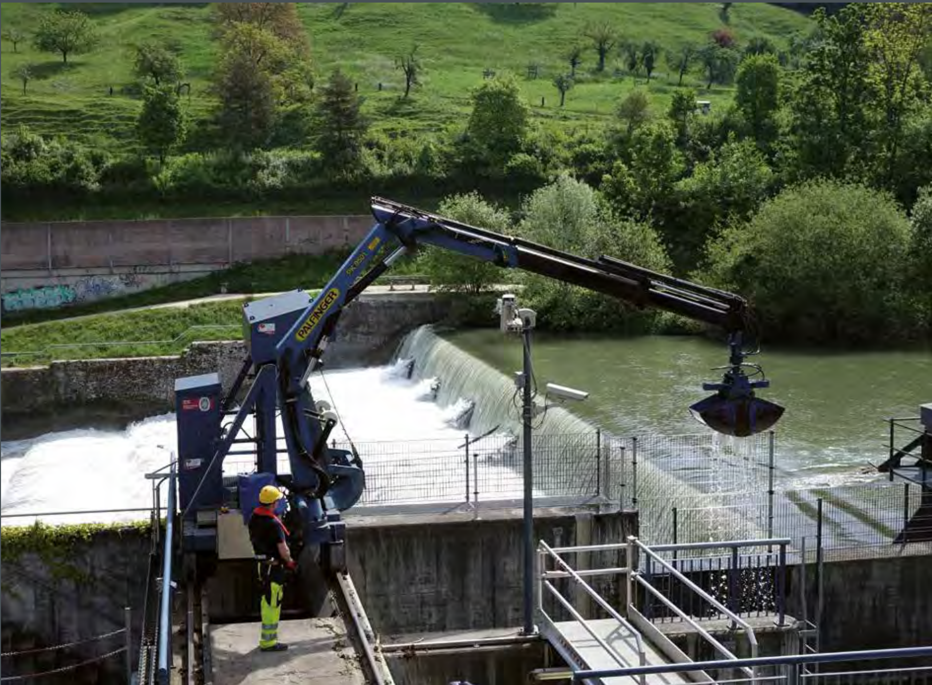
Der Wasser-Einlaufkanal muss regelmässig ausgebaggert werden.
